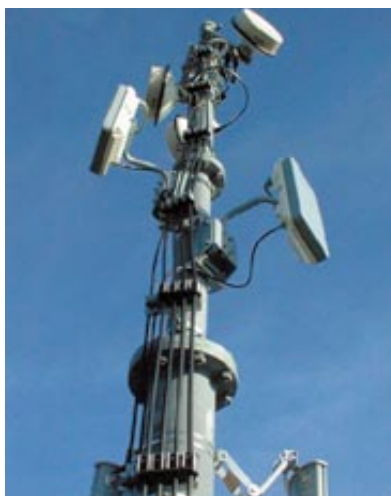
Antennenmasten für Mobilfunkanwendungen sind in den vergangenen Jahren zu einem selbstverständlichen Bestandteil der Umwelt geworden. Fotos (2): Viag Interkom
